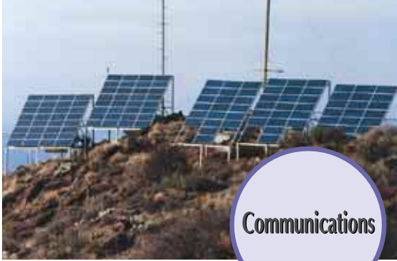
U.S.A : 6.7kW / Telecom
